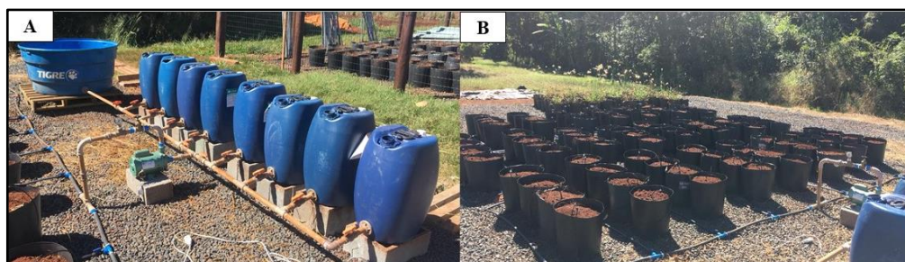
Figura 1. Sucção, bombeamento e recalque (A) e, linha principal e de gotejamento (B) do sistema de irrigação.
